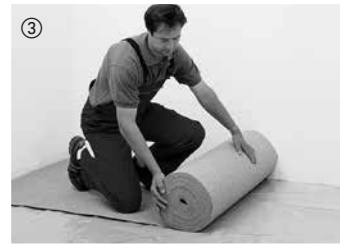
Zur Trittschalldämmung und zum Ausgleich kleiner Unebenheiten wird eine 2 mm dicke Korkdämmunterlage bündig ausgerollt. Alternative Dämmunterlagen finden Sie in unserem Zubehörangebot. Bitumenpappe eignet sich nicht zur Trittschalldämmung. Bei HARO Laminatboden mit Silent Pro® darf keine zusätzliche Dämmunterlage ausgelegt werden.
