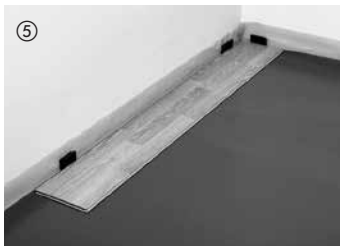
In der rechten Raumecke beginnend, werden die Elemente mit der Federseite zur Wand verlegt und mit Abstandskeilen fixiert (Dehnungsabstand zur Wand 10--15 mm).
