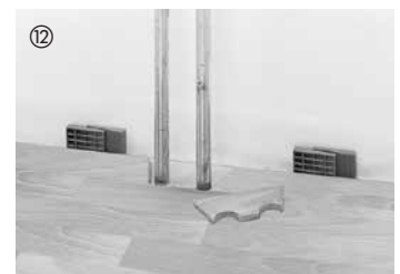
Für aus dem Boden herausragende Heizungsrohre werden in die Elemente Öffnungen (Größe abhängig vom jeweiligen Heizungsrohr und unter Berücksichtigung des erforderlichen Dehnungsabstands) gebohrt oder gesägt.
