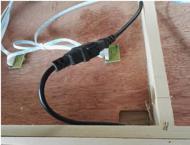
Bild 18: Stromkabel Seitenwand und Decke
