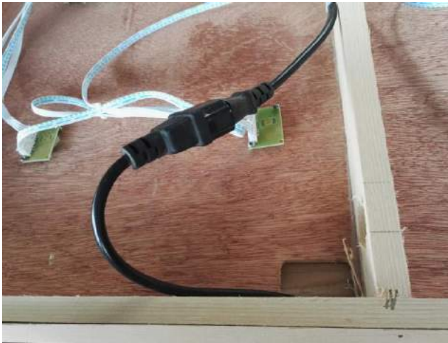
Bild 18: Stromkabel Seitenwand und Decke
