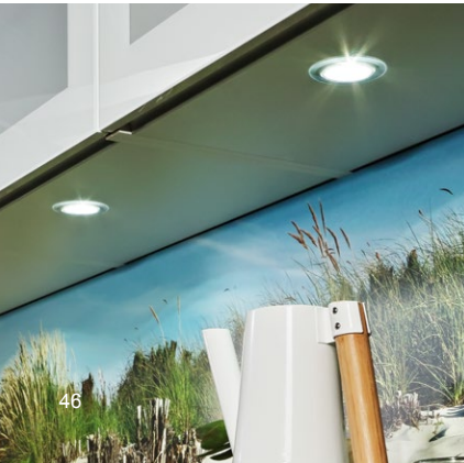
Runde LED-Einbaustrahler für maximale Harmonie: Eingelassen in eine Fräsung im Unterboden und versehen mit einer unsichtbaren Kabelführung. Round built-in LED spots for maximum harmony: flush-fitted in an aperture in the bottom panel and installed with concealed cable routing.
